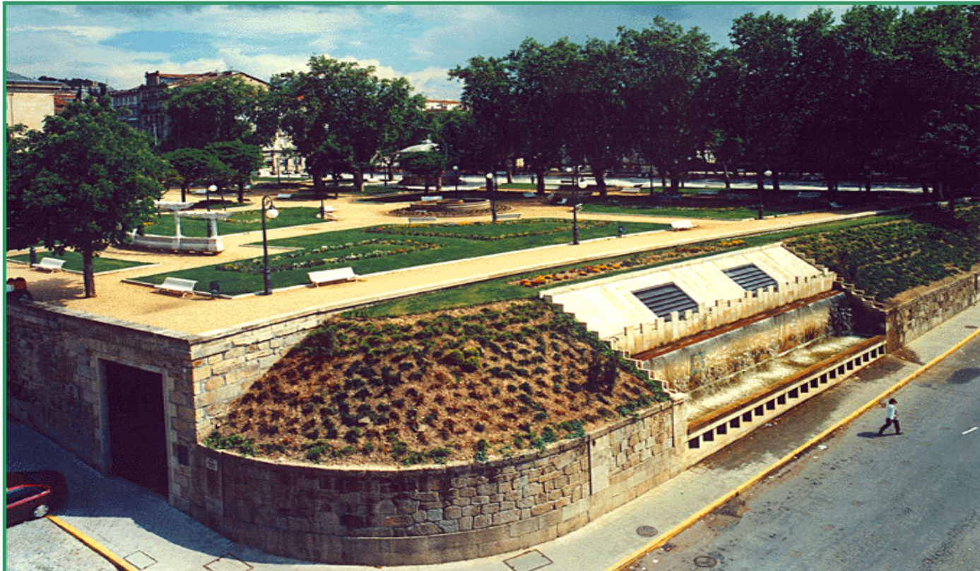
Subestación subterránea Barbaña, España 132 kV, 40 kA, Configuración simple barra (3 CB) Transformador 132/20 kV, 15 MVA
