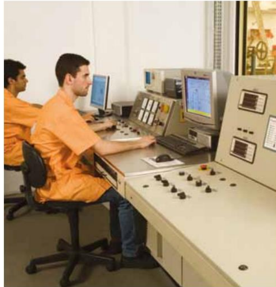
Sala de control
