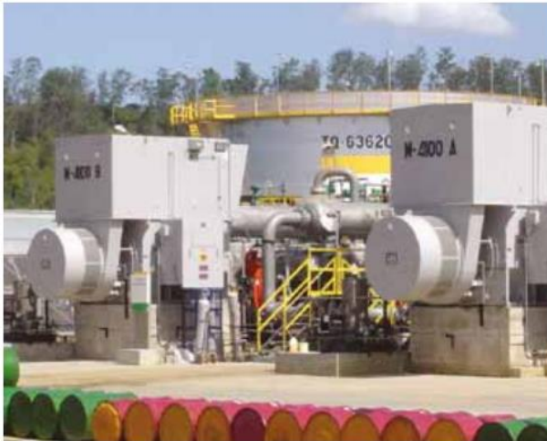
Motores sincrónicos SEF900 (Ex-p), 3.600 kW, 13.200 V Aplicación: Compresores recíprocos (petroquímica)
